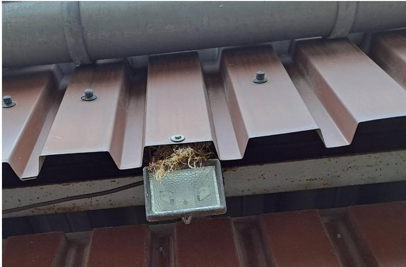
Bild 5: Nistmaterial auf einem Strahler an der Außenwand, vermtl. Haussperling oder Blau-/ Kohlmeise (eigene Aufnahme, 26.03.2024)
