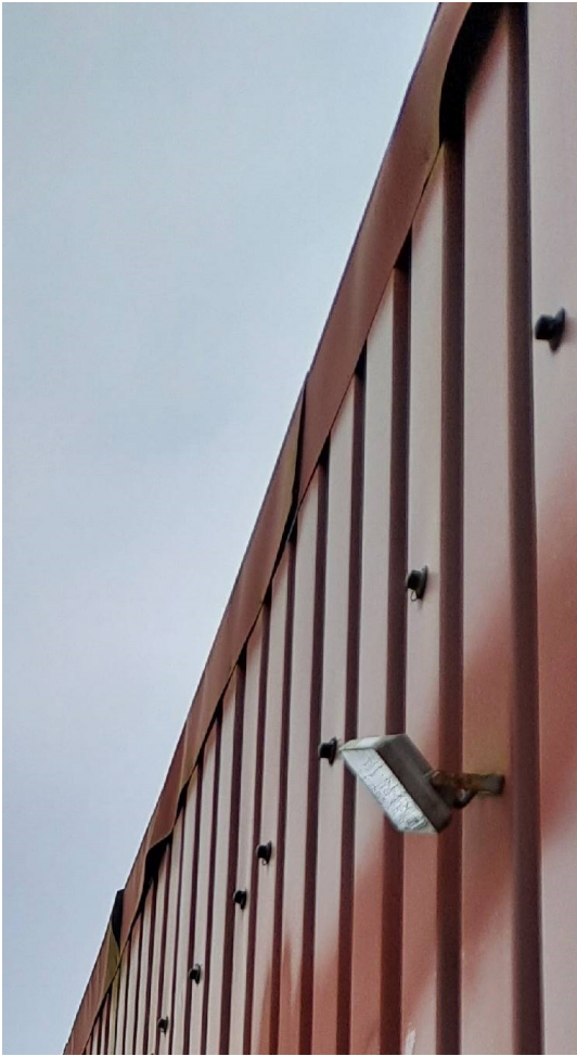
Abbildung 1: Zwischenräume im Bereich der Dachüberlappung an der Halle aus Trapezblech (eigene Aufnahme, 26.03.2024)
